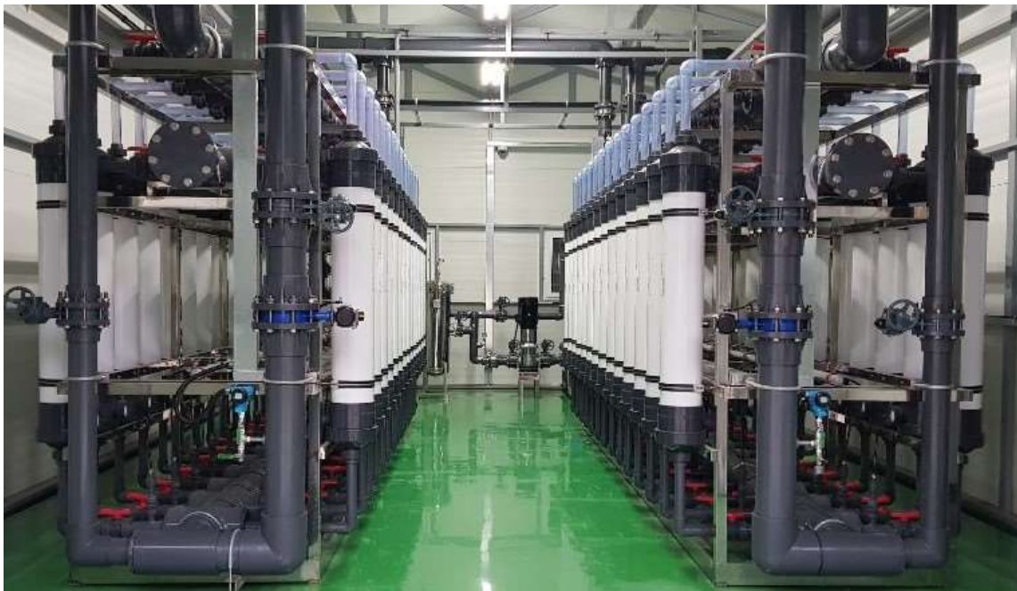
베트남 소재의 시노펙스비나2 사업장에 설치된 모습
